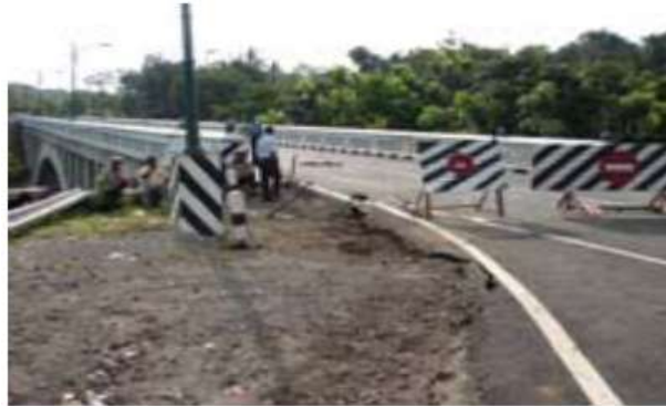
Gambar 2: Jembatan Irung Petruk yang rusak akibat gempa Yogyakarta tanggal 27 Mei 2006
