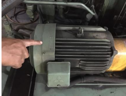
Gambar 5. Motor Pompa Hidrolik
