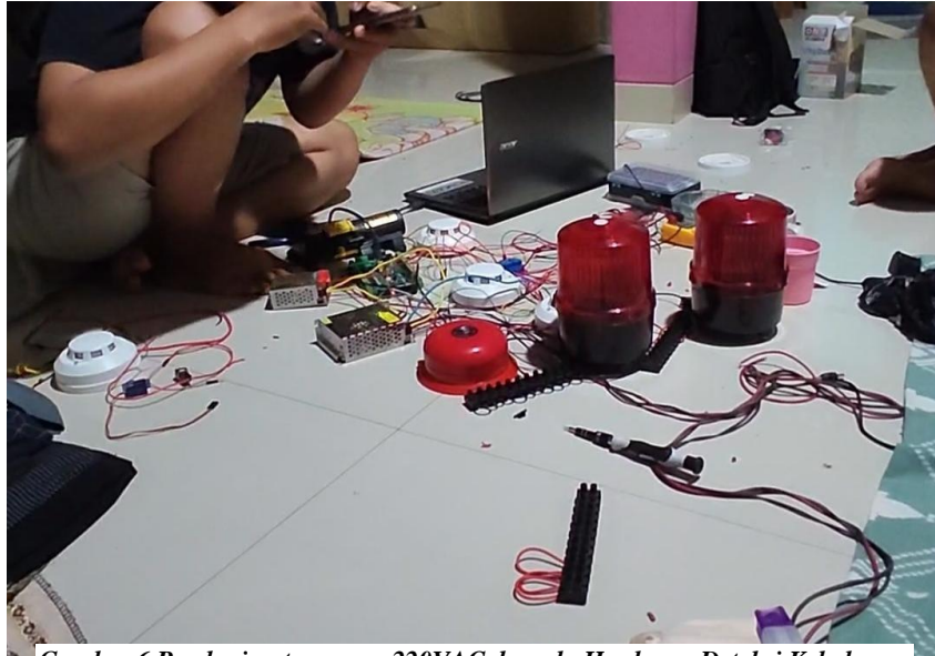
Gambar 6 Pemberian tegangan 220VAC kepada Hardware Deteksi Kebakaran dengan Smoke Detector Addressable Berbasis Outseal PLC Mega V.3 Standart
