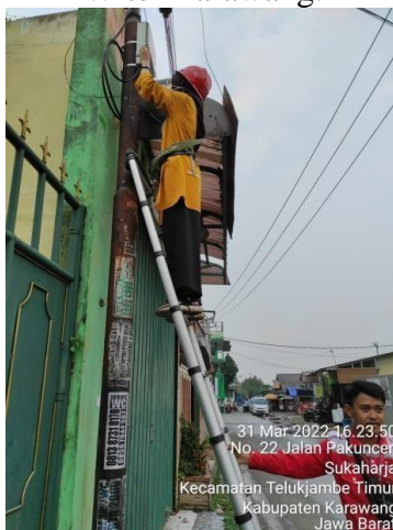
Gambar 19 Proses validasi odp panel pole di lapangan.
